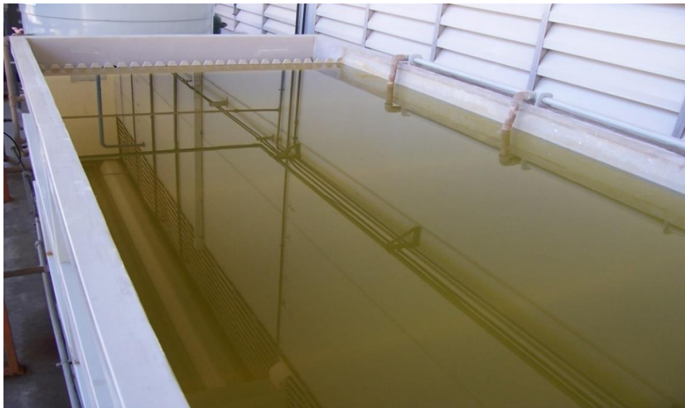
Figura 22 – Tanque de decantação.
