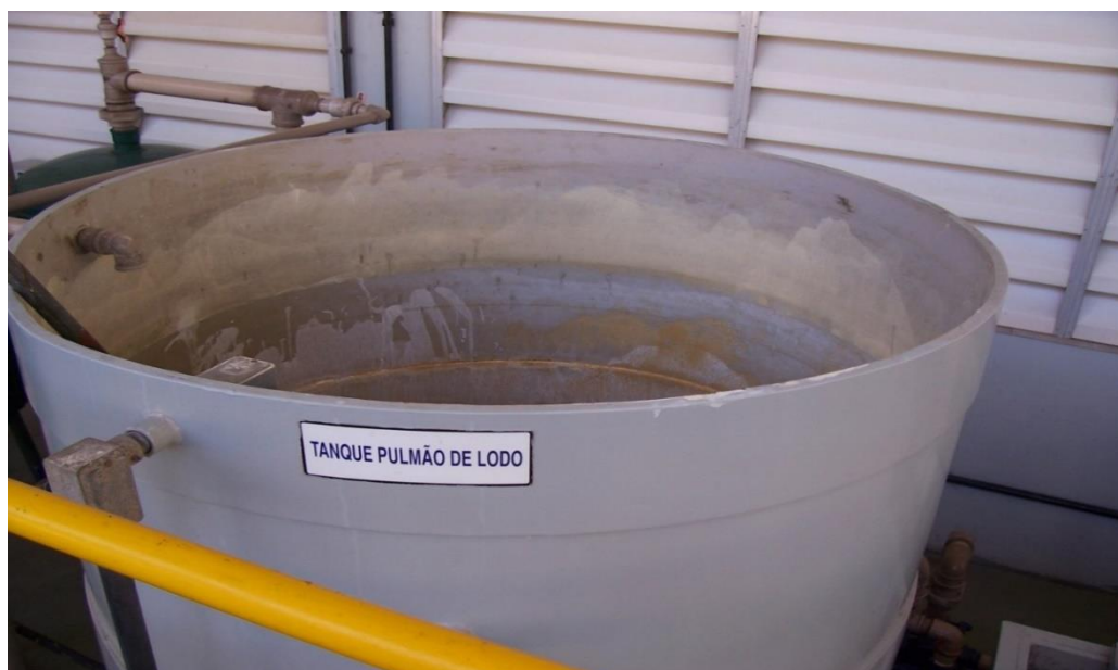
Figura 21 – Tanques Pulmão\ Polimento.
