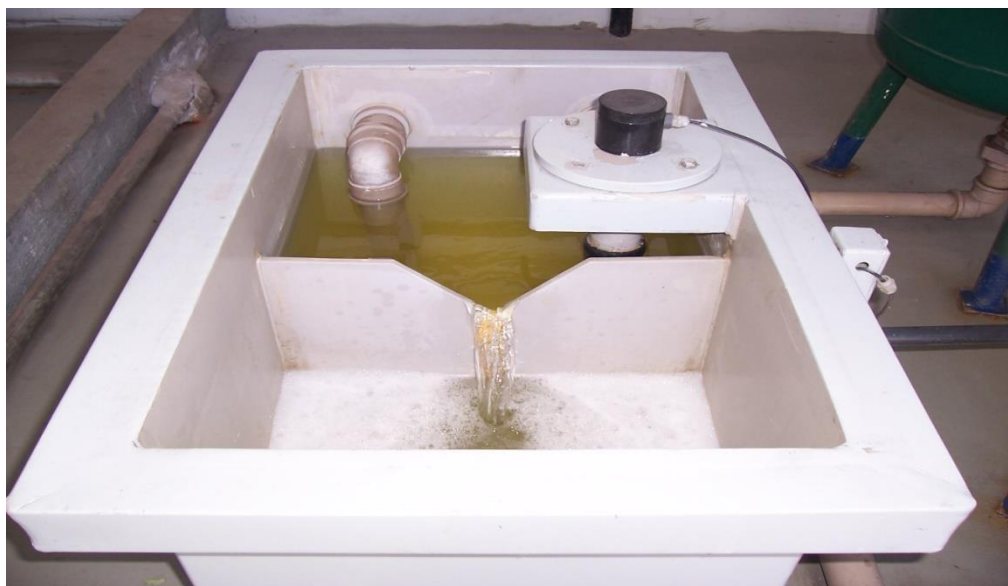
Figura 28 – Efluente final Tratado.
