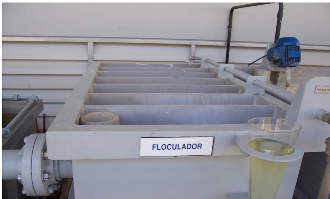
Figura 19 – Tanque de Floculação.
