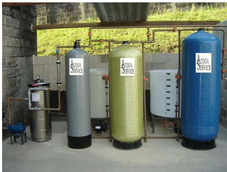
Figura 4 – Sistema de desmineralização para abastecimento de processos industriais.
