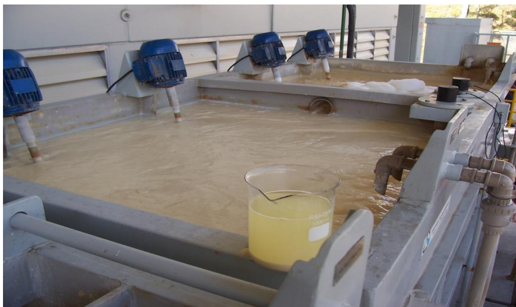
Figura 20 – Tanques de Precipitação/neutralização.
