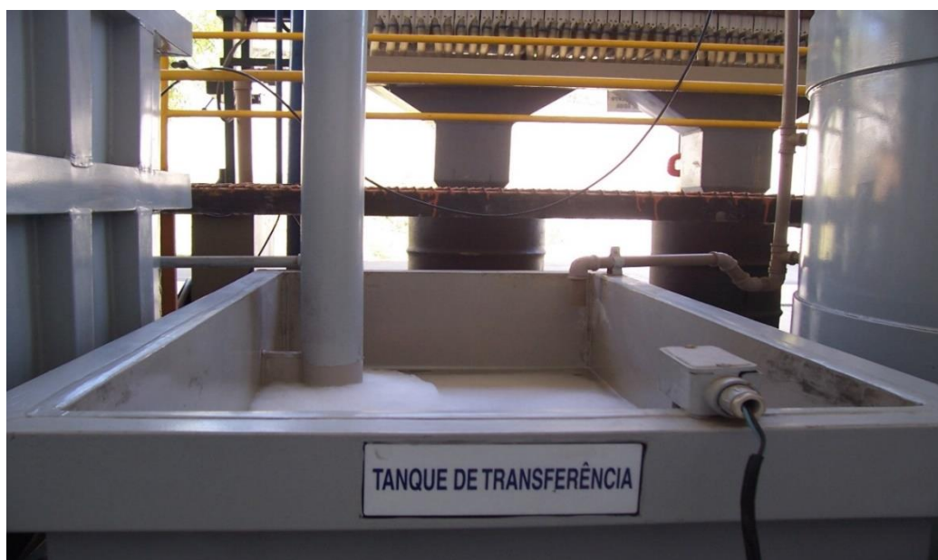
Figura 24 – Tanque de Transferência.
