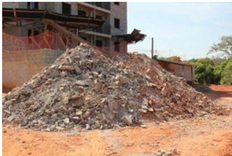
FIGURA 19 - RESÍDUOS DA CONSTRUÇÃO CIVIL: ENTULHOS
