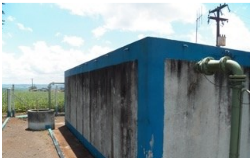
FIGURA 32 - DUTO DE ADUÇÃO DA CAPTAÇÃO AO RESERVATÓRIO DA CIDADE DE IVATUBA
