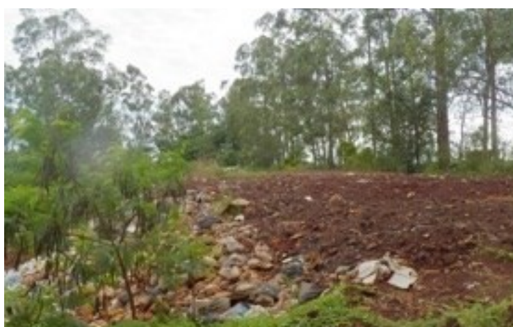
FIGURA 44 - LANÇAMENTO DE TERRA SOBRE O LIXO DEPOSITADO
