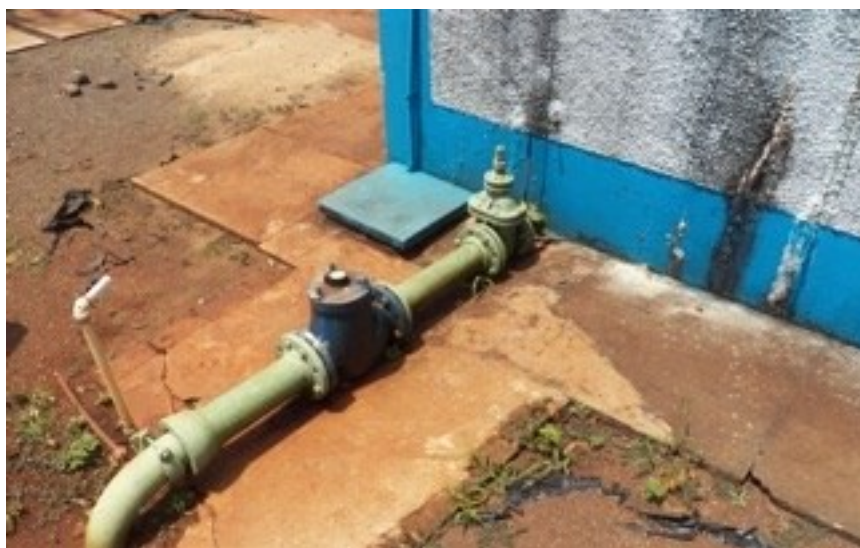
FIGURA 35 - TUBULAÇÃO DE SAÍDA PARA O SISTEMA DE DISTRIBUIÇÃO
