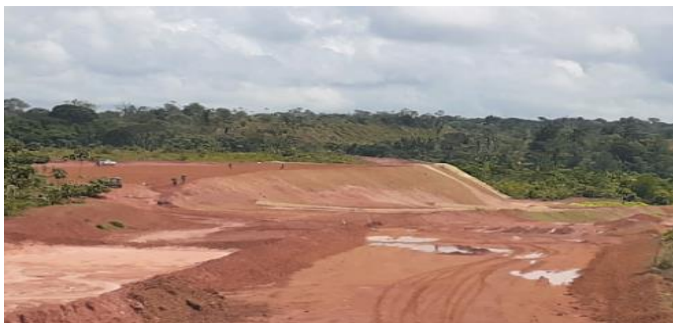
Figura 22 Avaliação fotográfica ( antes), Mina RCC Ipixuna do Pará – PA.
