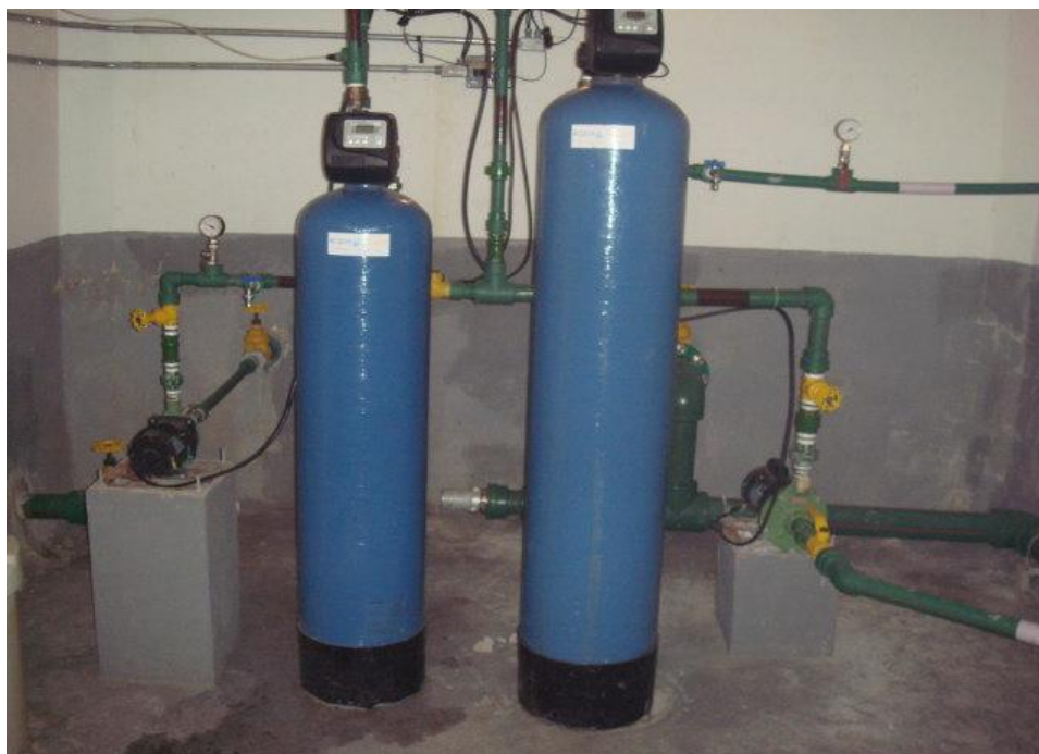
Figura 5 - Sistema de tratamento de água Eldorado Business Tower
